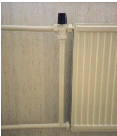
Typischer Einrohranschluss mit Handventil vor der Rekonstruktion in Halle-Neustadt (1992)
